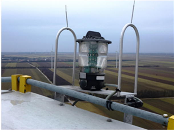
Abbildung 9: Blitzfangstangen neben Warnlampe auf dem Maschinengondeldach
