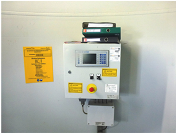
Abbildung 11: Steuerungs- und Überwachungsanlage
